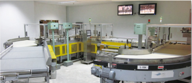
タイヤ材料用ゴム搬送設備
