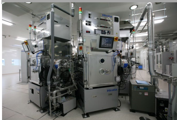
有機EL関連装置 真空蒸着装置
